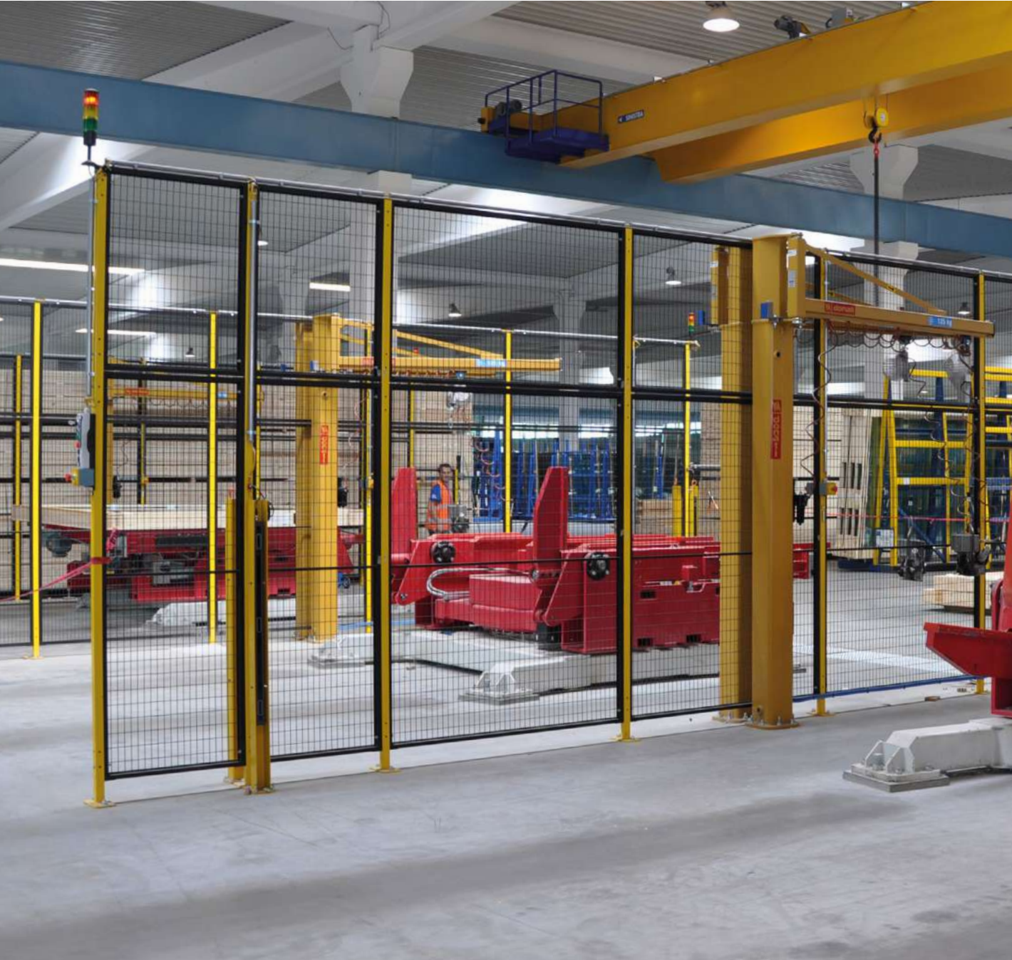
Exemple d'application du système Novatek pour la délimitation des zones de manutention de charges en hauteur.
