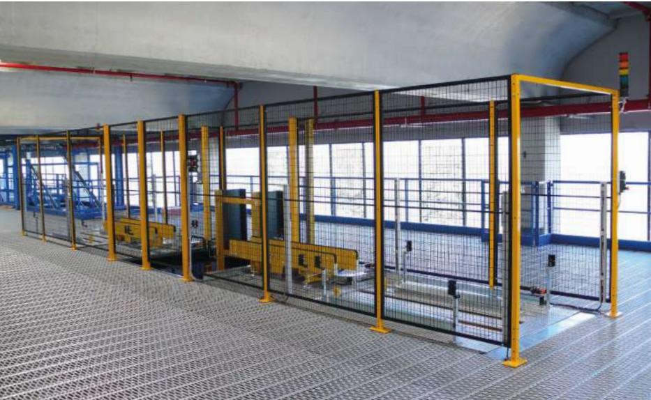
Exemple d'applications du système Novatek pour la délimitation de zones avec des machines dangereuses.
